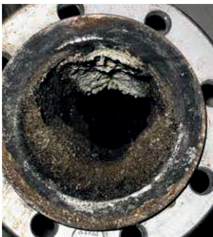
Obr. 4: Vysrážení struvitu v potrubí pro digestát
